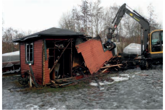
Georg Ponsaing's garderobebygning rives ned efter de omfattende brandskader. En bygning der i 90 år var til glæde og nytte for medlemmerne endte på skammeligste vis som flammernes bytte.
